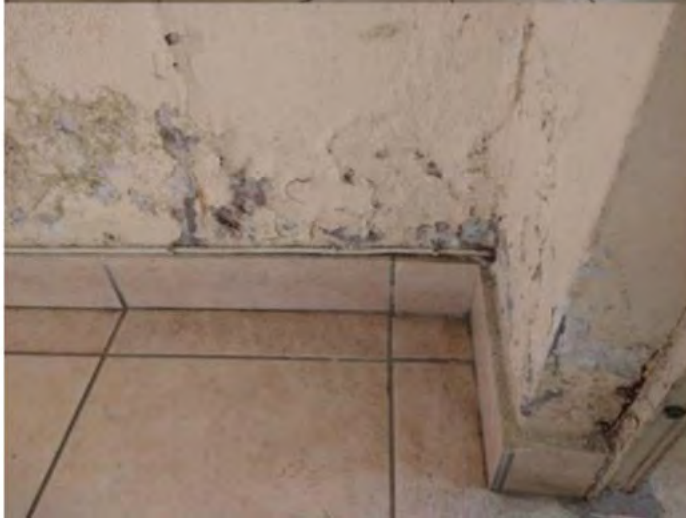
2 - ammaloramento della fascia inferiore di intonaco lungo le pareti perimetrali interne alla
